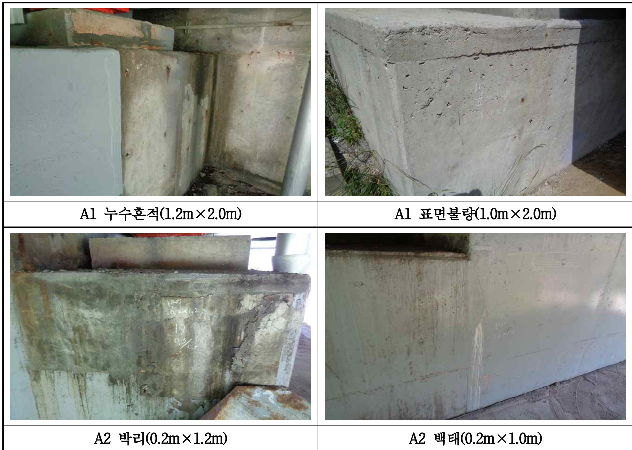
【사진 3.36】교대 손상현황
