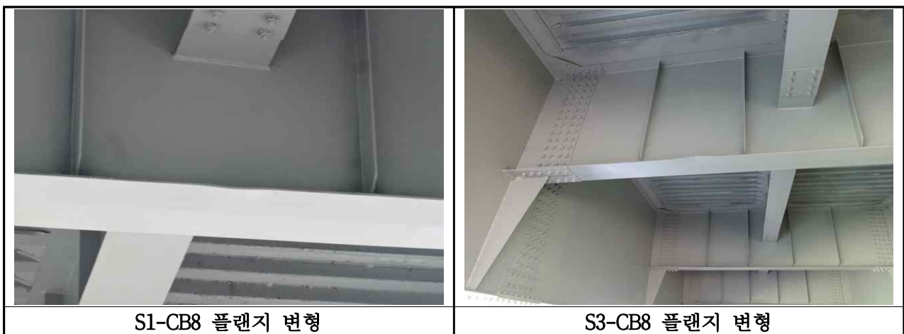
【사진 3.8】 가로보 및 세로보 손상현황
