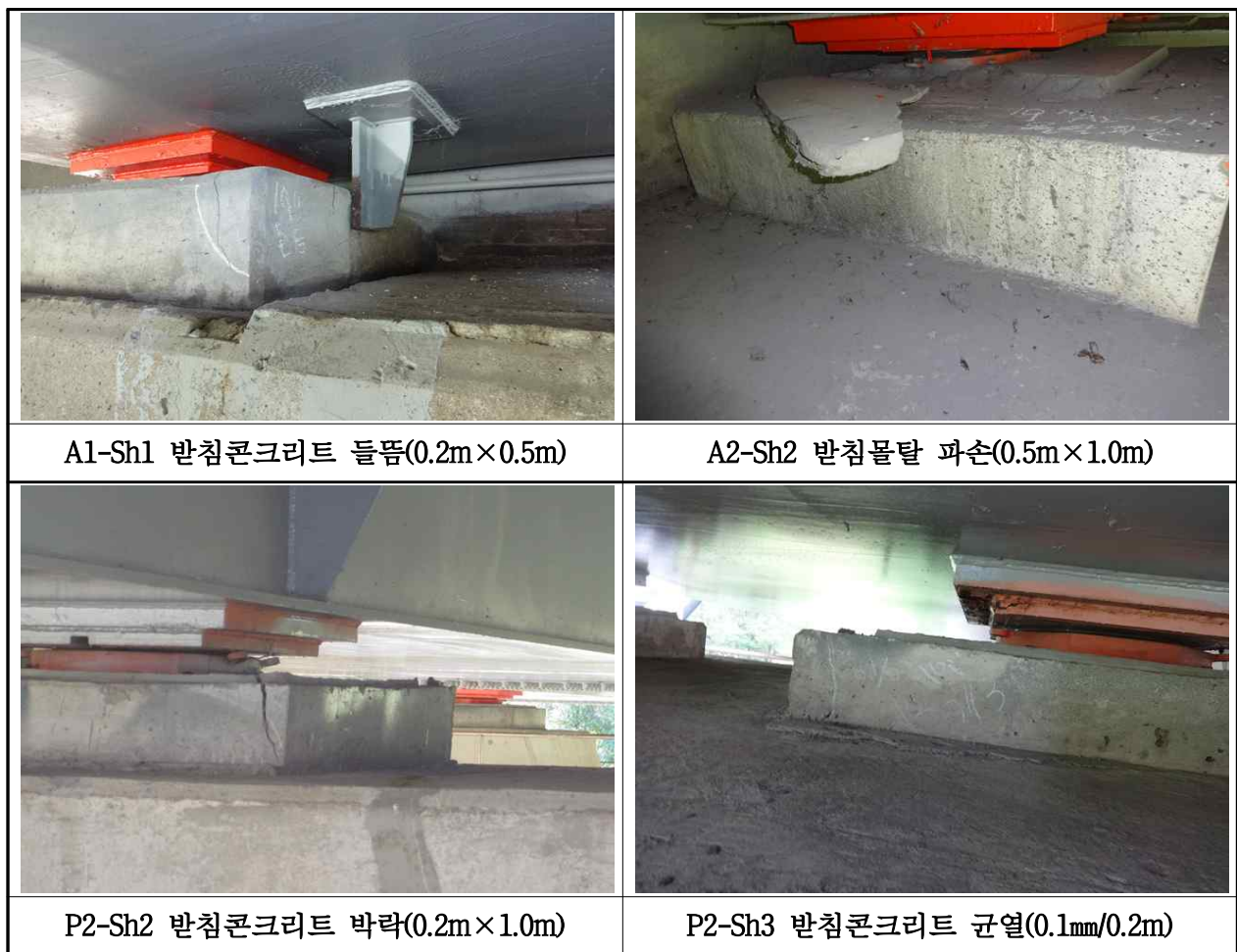
【사진 3.14】교량받침 손상현황
