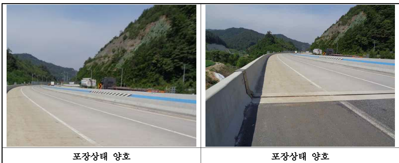
【사진 3.47】 교면포장 손상현황
