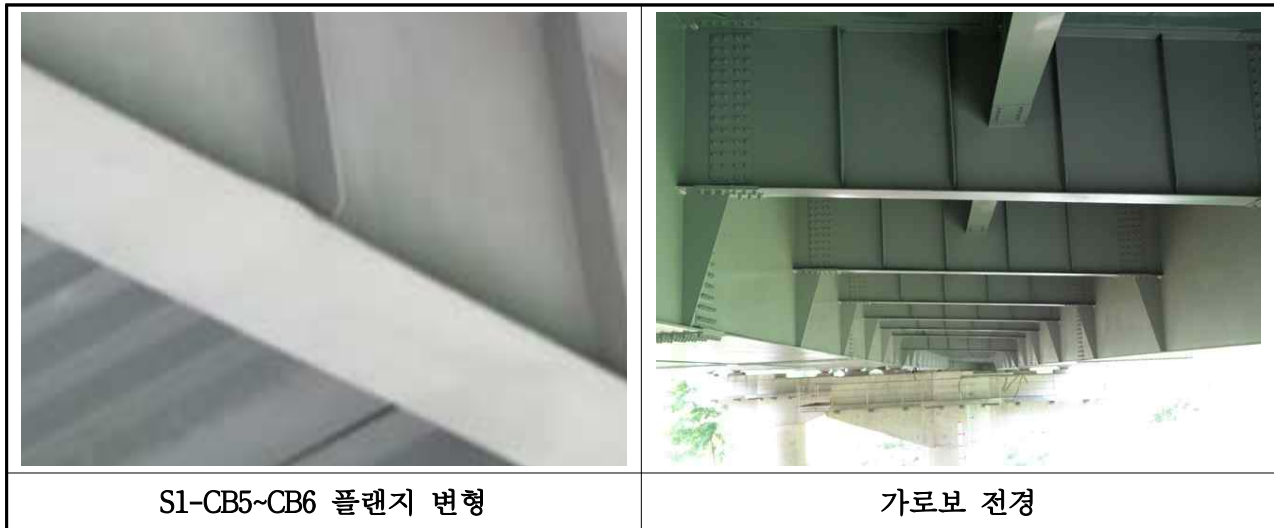
【사진 3.34】 가로보 및 세로보 손상현황
