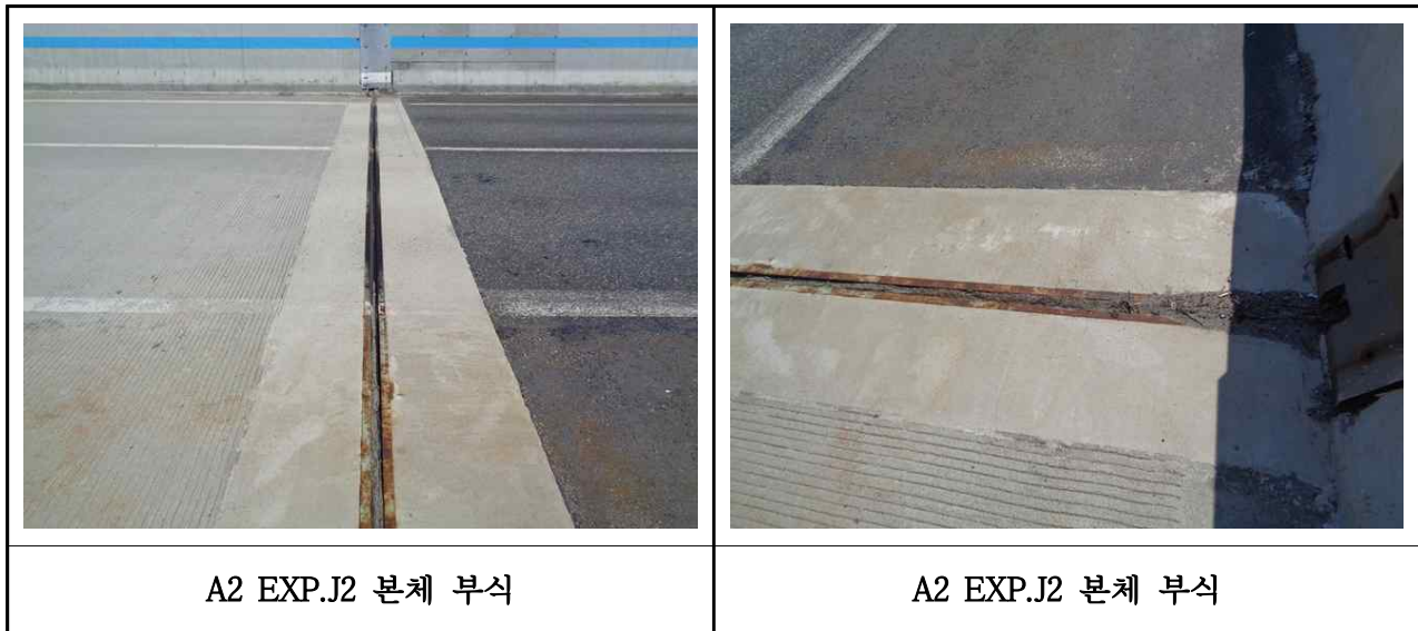
【사진 3.44】 신축이음장치 손상현황
