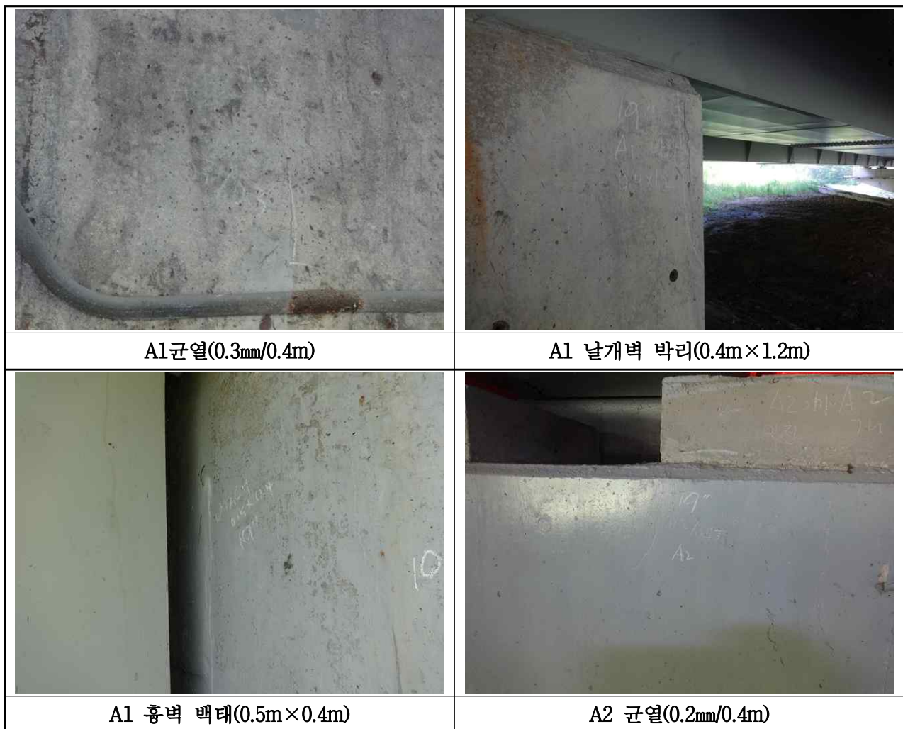
【사진 3.10】 교대 손상현황
