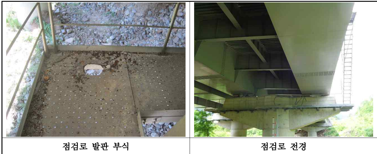
【사진 3.27】 교량 점검시설 손상현황
