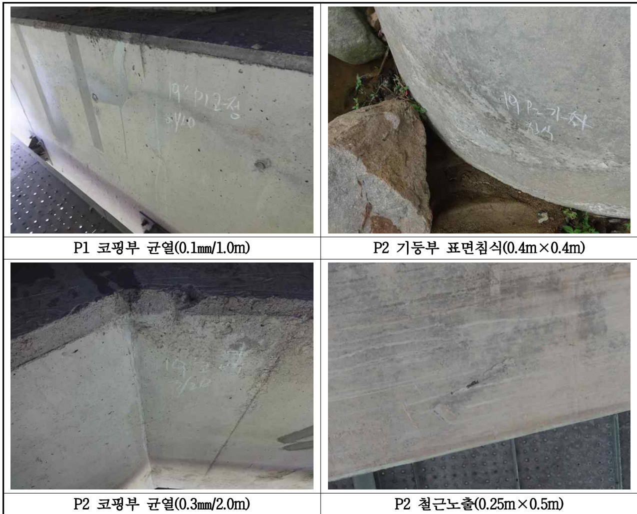
【사진 3.12】교각 손상현황
