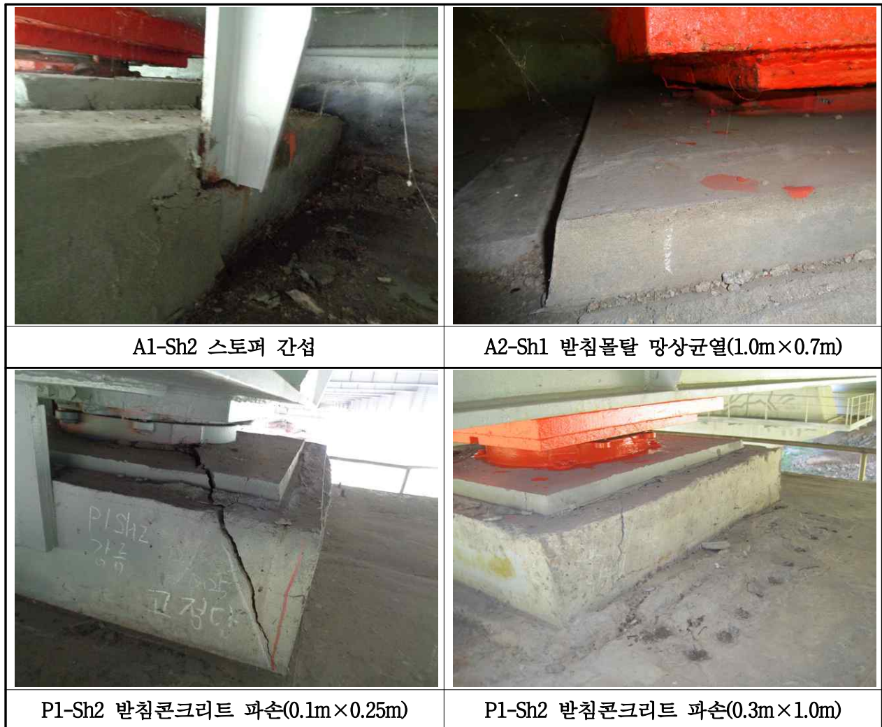
【사진 3.40】 교량받침 손상현황
