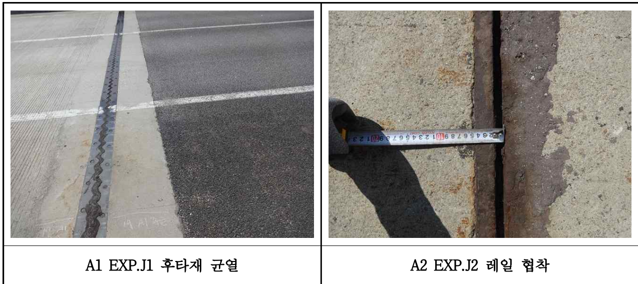
【사진 3.18】 신축이음장치 손상현황
