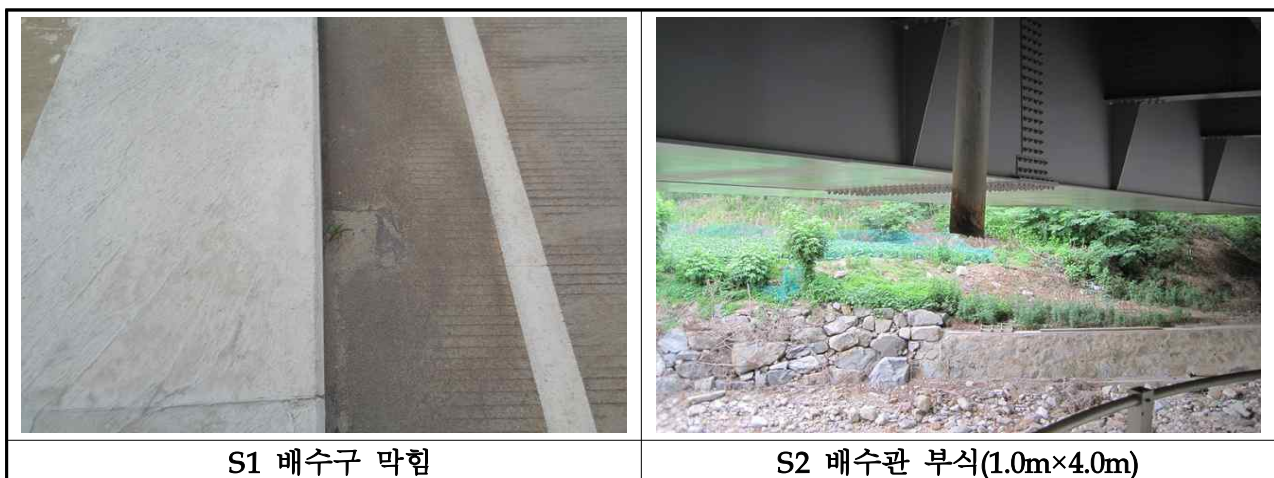
【사진 3.23】 배수시설 손상현황
