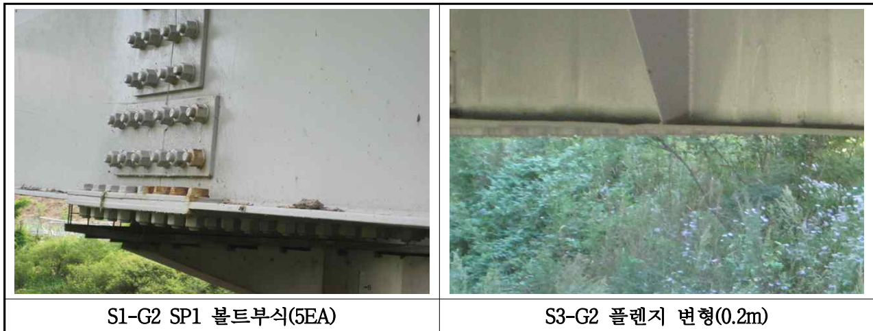
【사진 3.5】 거더 외부 손상현황
